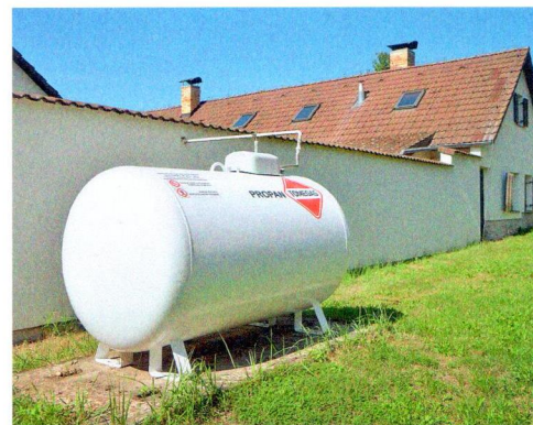
Zásobník na kapalným plyn je možné instalovat na pozemku nebo také schovat pod zem
